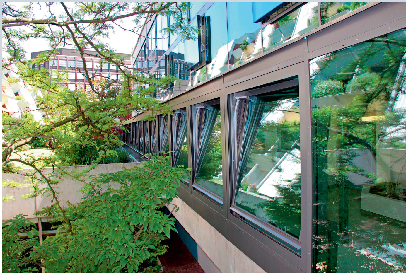
Ansicht von aussen: Langsam öffnen sich die Hubkippfenster gegen innen.
